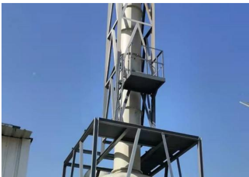
蒸发结晶车间水膜除尘器排气筒采样平台
