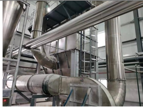
蒸发结晶车间袋式除尘器
