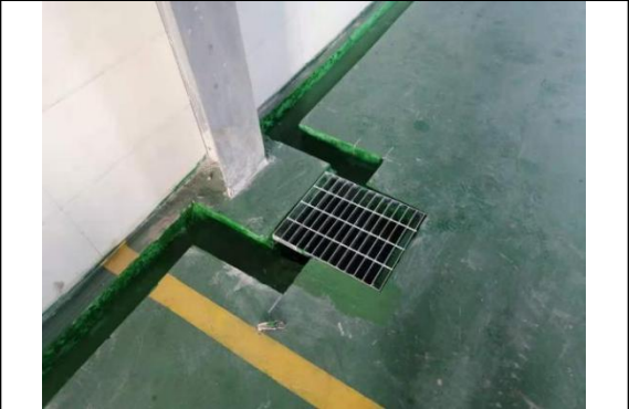
危废暂存库导流槽及集液坑
