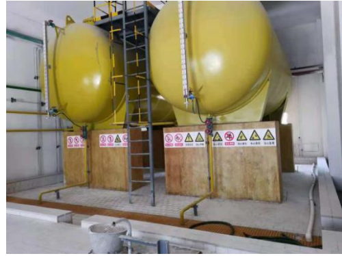
氢氧化钠溶液储罐围堰
