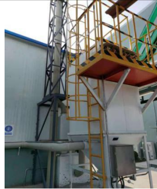
加药间脉冲袋式除尘器
