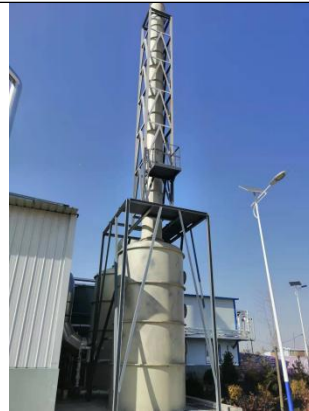
蒸发结晶车间水膜除尘器
