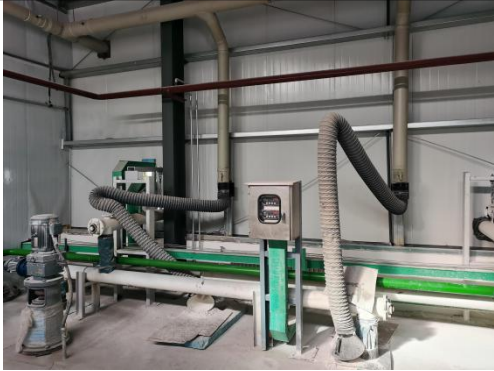
加药间粉尘收集系统
