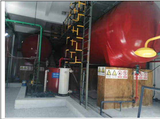
硫酸、盐酸储罐围堰
